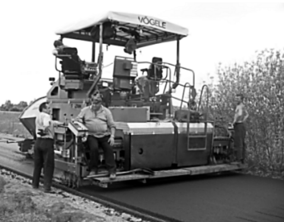
Prace przy pokrywaniu drogi gminnej warstwą szczelnego asfaltu. W ten sposób zahamowano emisję pyłu azbestowego do powietrza.
