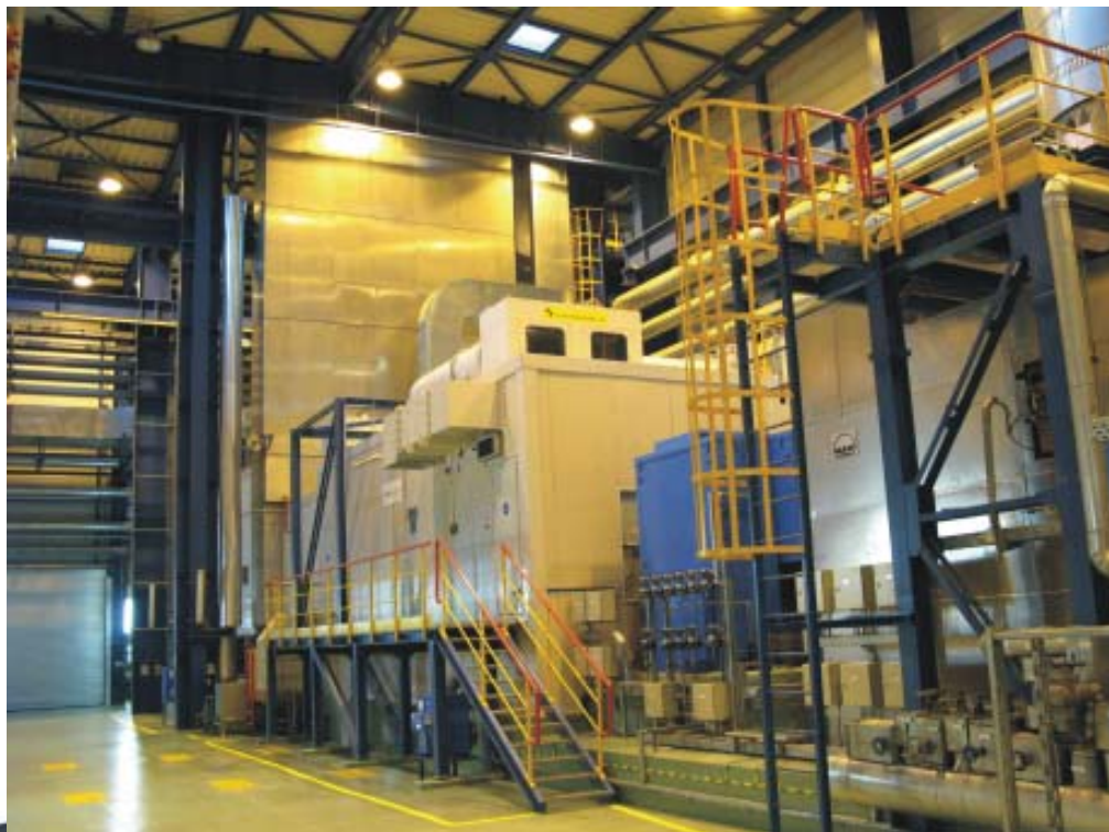
Zabudowana turbina gazowa o mocy około 100 MW.
