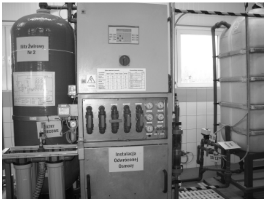
Głównym elementem oczyszczalni jest instalacja odwróconej osmozy.
