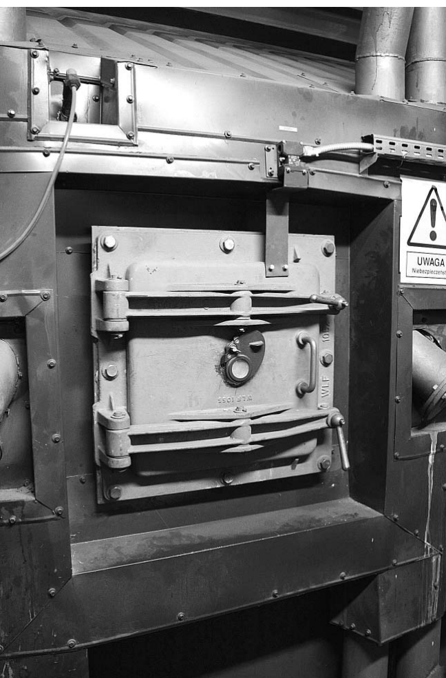
Za tymi żeliwnymi drzwiczkami hula 10 megawatów mocy.
