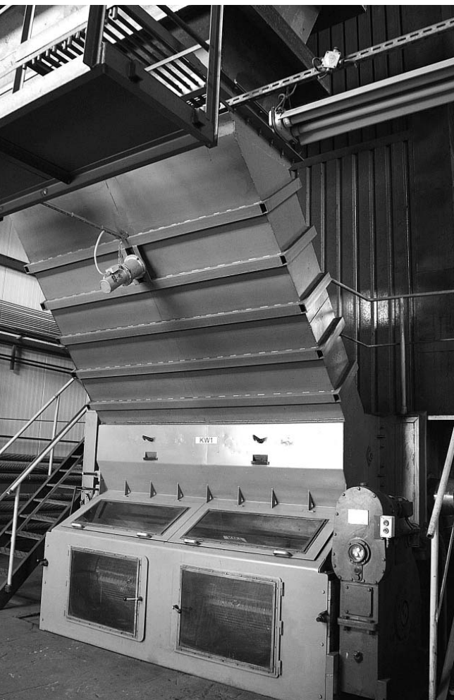
Stary kocioł węglowy też uległ gruntownej modernizacji.
