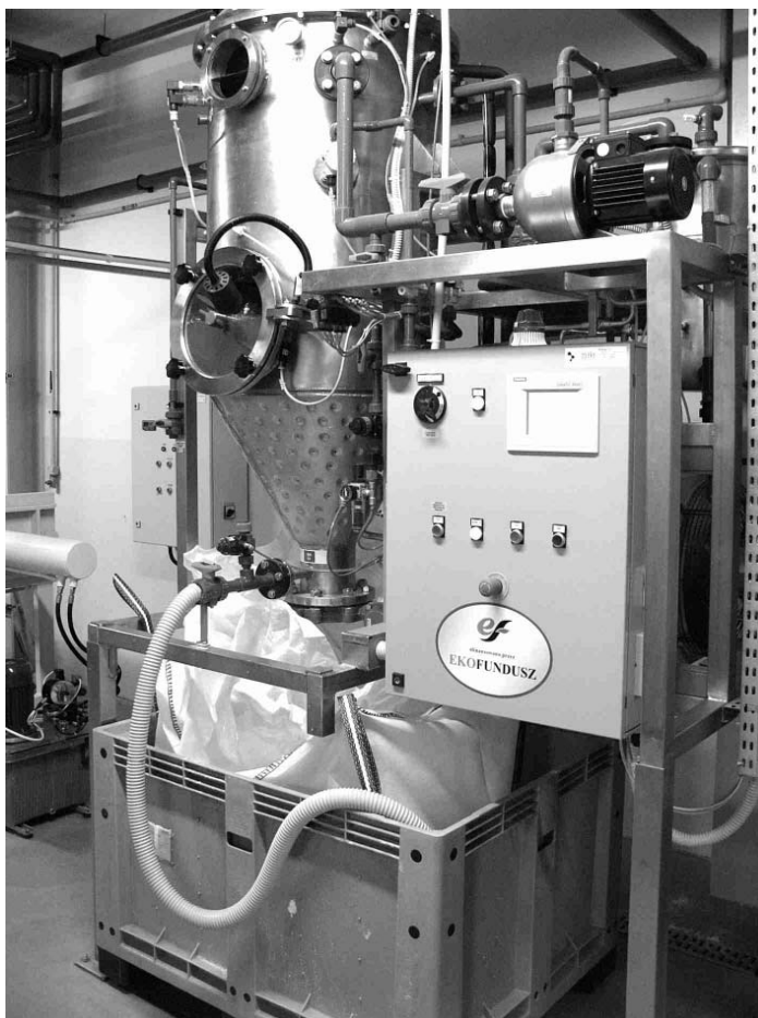
Krystalizator ścieków chromowych pozwala na wykrystalizowanie ze ścieków soli chromu i otrzymanie niemal czystych ścieków.
